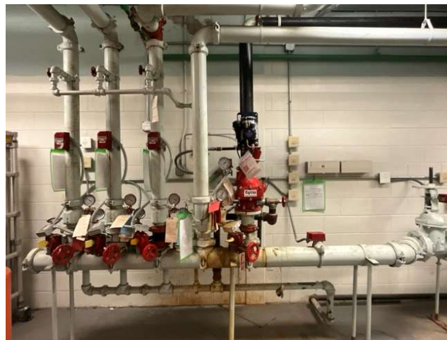
30 - FIRE SPRINKLER RISERS
